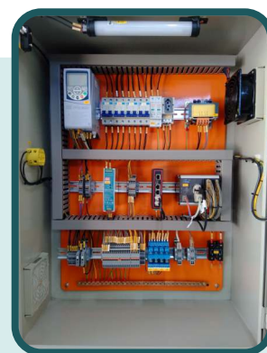
Sistema de Lubrificação de Mancais EMBASA
